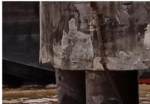
Gambar 4. Penampakan kerusakan yang terjadi.
